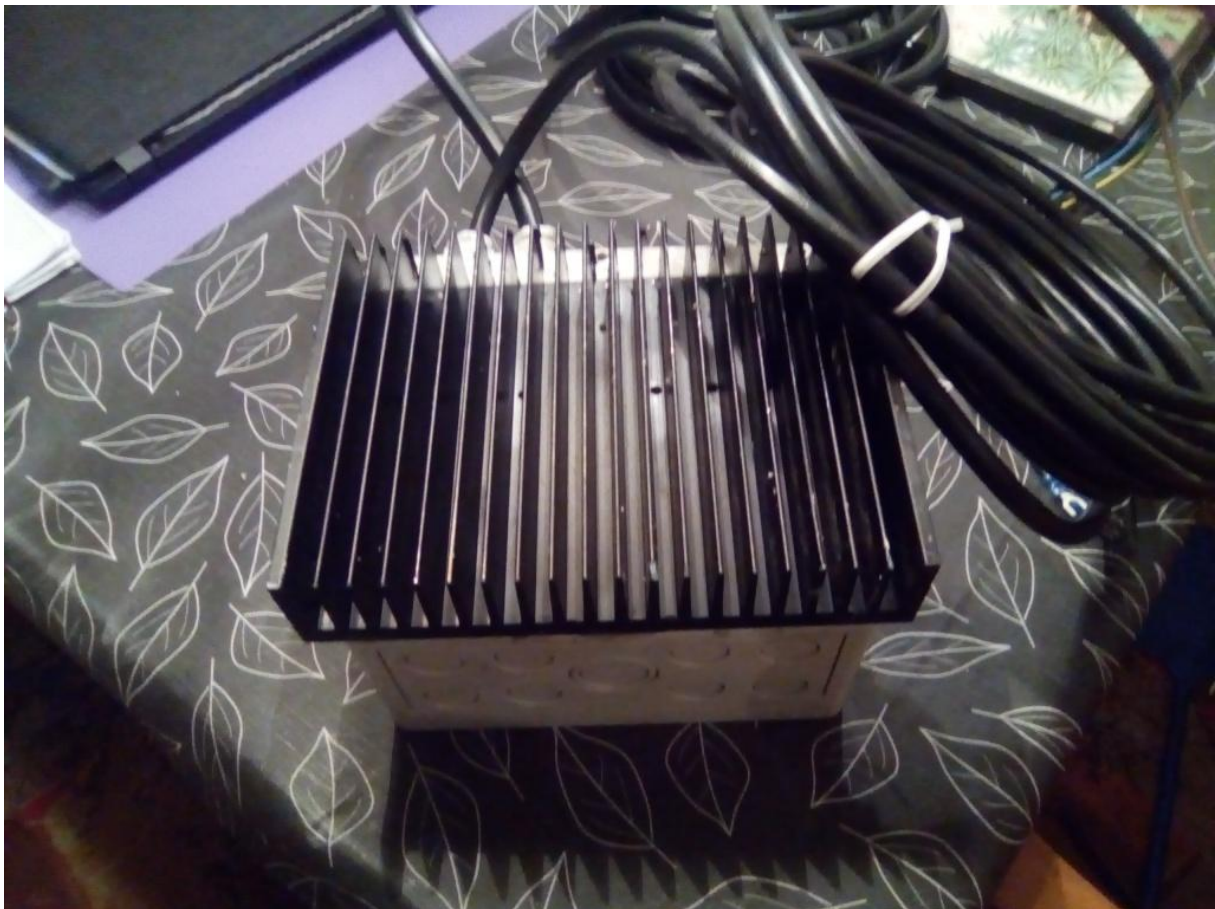
I Koelblok op de rug van een installatiekast.
