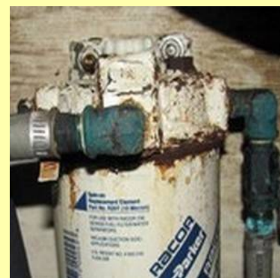
Als een brandstoffilter zo roestig is wat zal de eigenaar nog meer niet
