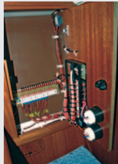
Sauber verlegte Elektrik
